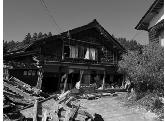
【写真3】大きく傾斜した家屋(珠洲市蛸島)
