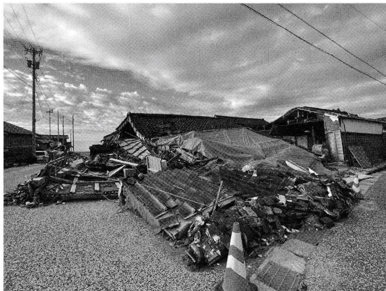
[写真1]倒壊した角海家の建物
