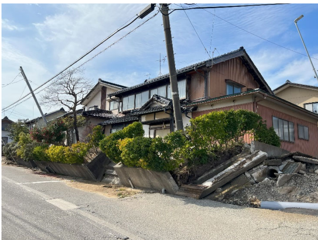
写真3 内灘町西荒屋の液状化&側方流動による被災例
