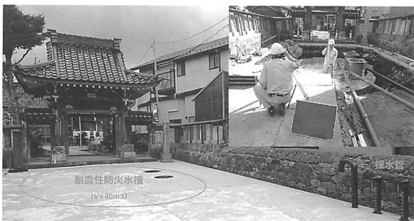
写真3 寺町台伝統的建造物群保存地区における寺院境内を活用した防火水槽整備事例 写真提供=金沢市
