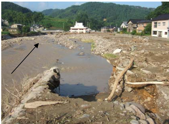
(c) 芝原橋上流右岸の堤防決壊の様子
