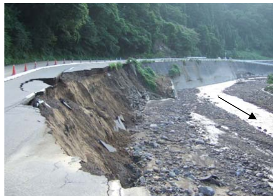
(b) 浅野川上流域の河岸道路侵食の様子
