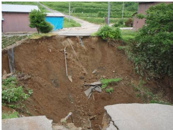
写真6-2 北袋町における道路崩壊に伴う配水管の折損
