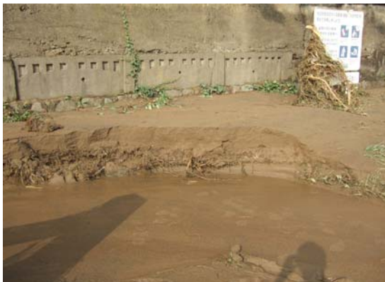
(i) 梅の橋下流左岸高水敷の土砂堆積
