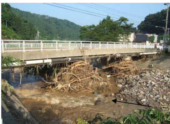
(e) 芝原橋周辺の土砂と流木の堆積
