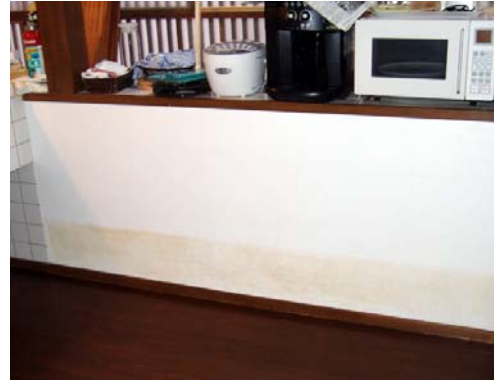
写真5-13 漆喰壁の変色部分が浸水水位
