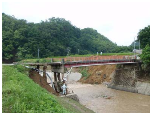
写真6-8 七曲町添架圧送管の折損
