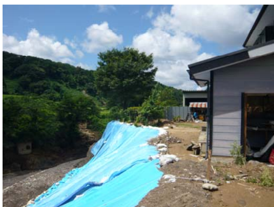
写真4-7 上流部（板ヶ谷町）の河川側の状況
