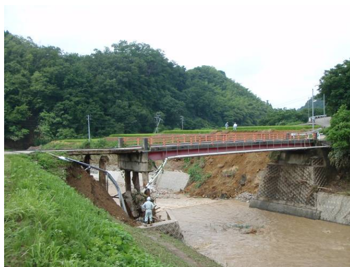
写真6-3 七曲町における橋梁左岸護岸の崩壊に伴う水管橋の折損
