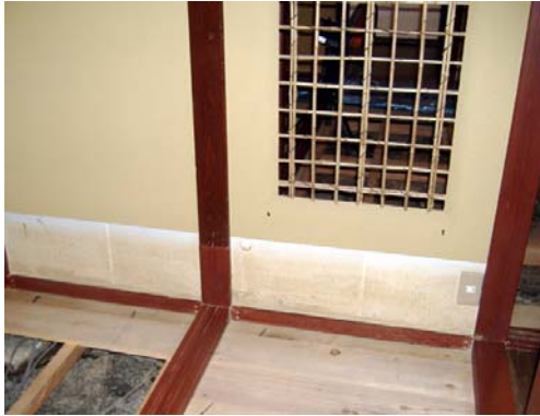
写真5-12 腰貼りの変色部分が浸水水位
