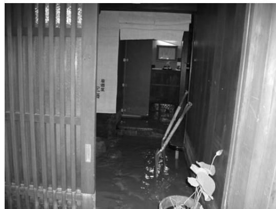
写真5-2 土砂が堆積した床上浸水家屋 (2)
