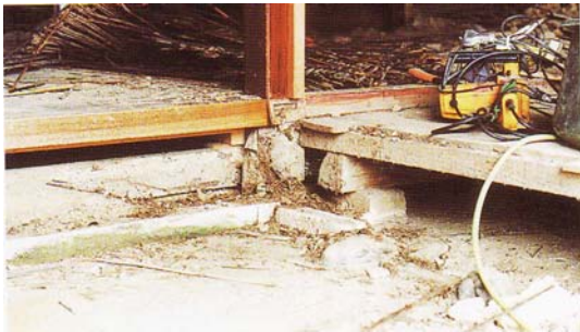
写真4-15 主計町の建物構造調査 基礎部の腐食（平成14年度）
