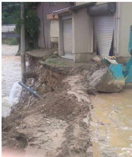
写真6-1 館町における道路崩壊に伴う配水管の流出
