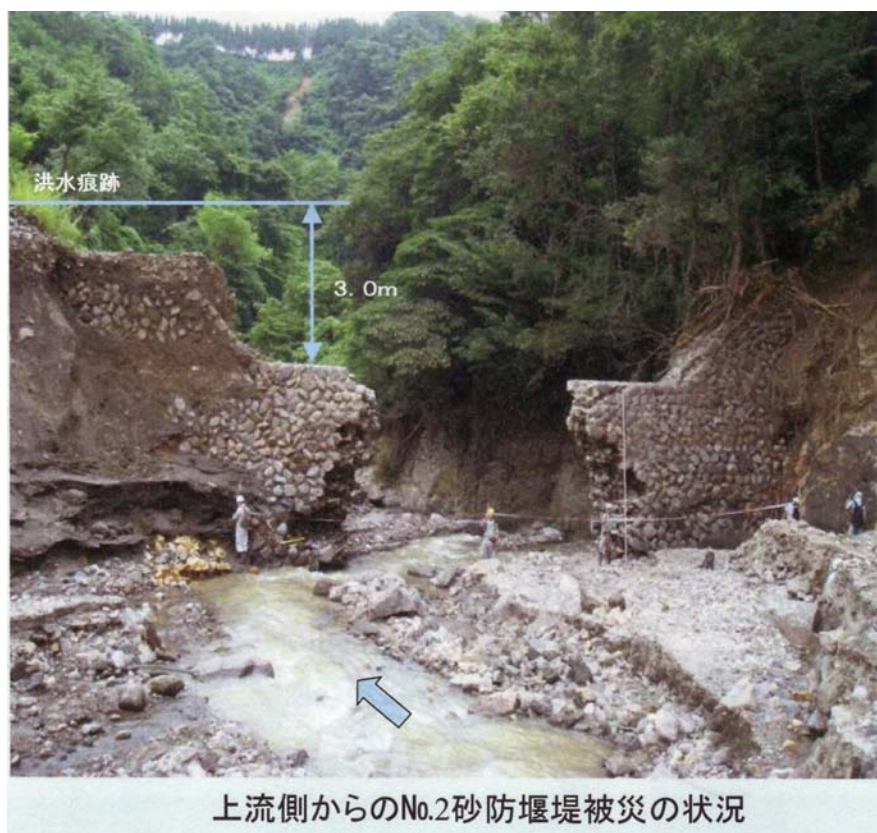
図3-4 2号砂防堰堤の被災状況 1)
