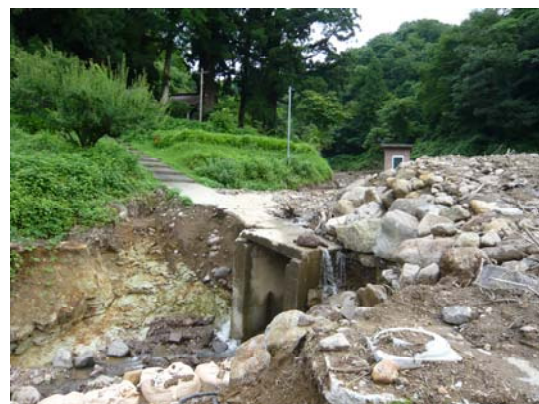
写真4-6 浅野川上流部（板ヶ谷町）の被害
