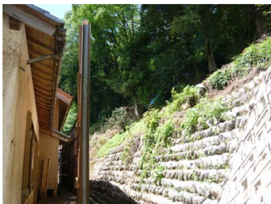
写真4-9 上流部（芝原町）被害と対策
